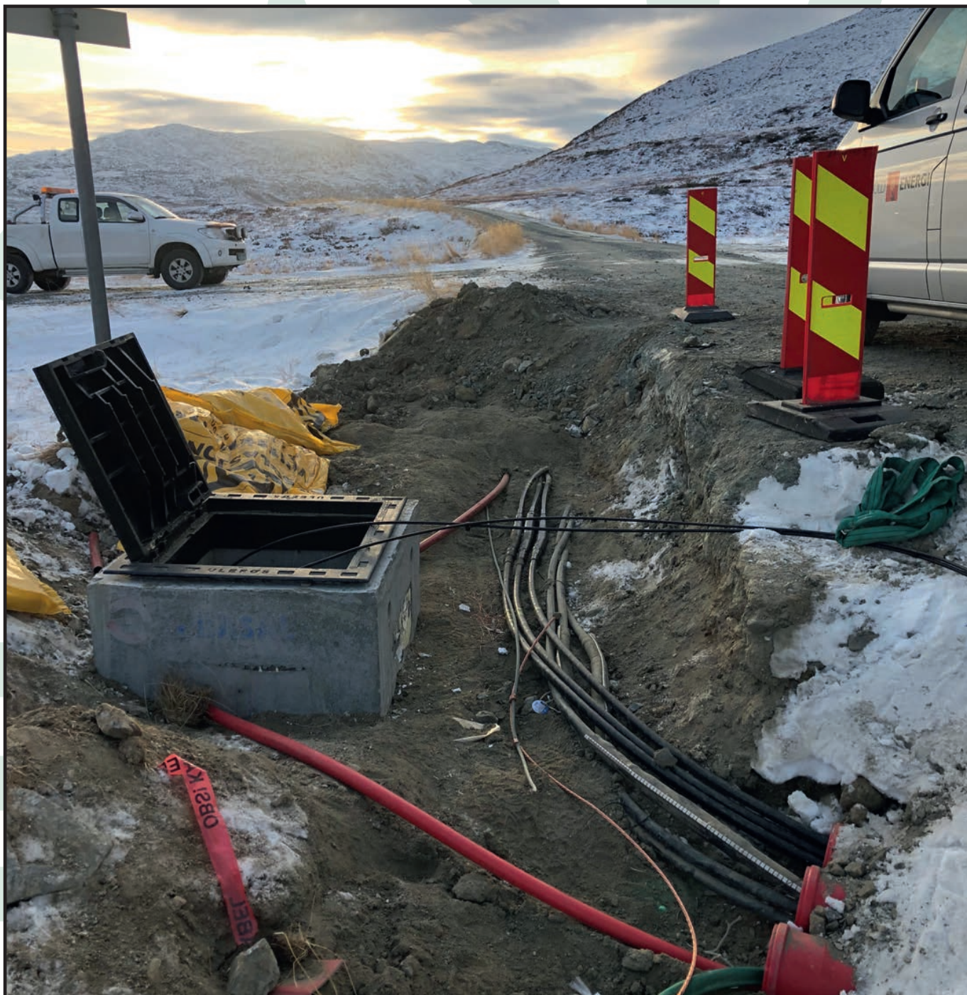
Kabelbrot ved Eldrevatn kraftverk
