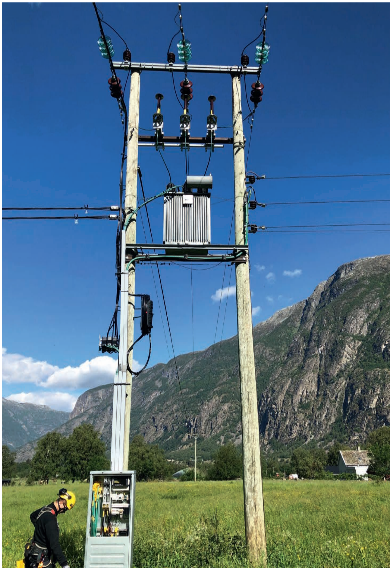
Stian ved nettstasjon Raa.
